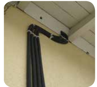
Leerrohre für TV
