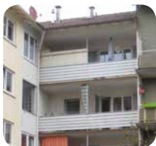
Balkone vor der Sanierung...
