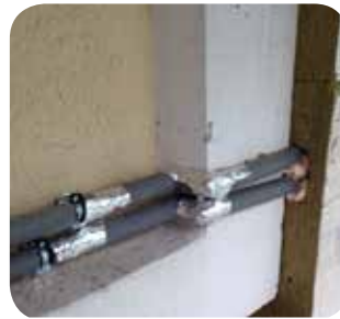
Heizleitungen auf der Fassade
