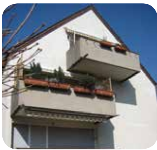
Balkone vor der Sanierung...
