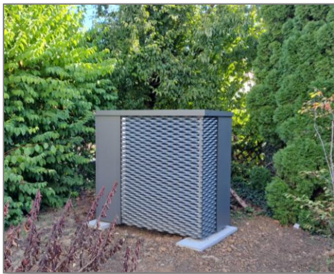
Außenaggregat einer Luft-Wasser-Wärmepumpe
